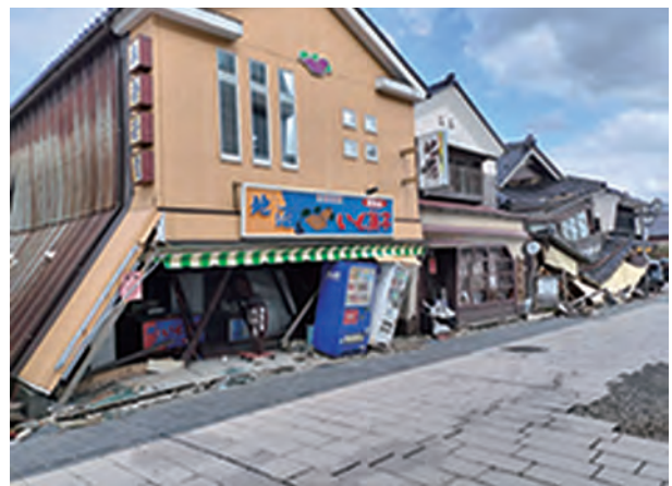
建物被害の例（20240310、輪島朝市地区）
